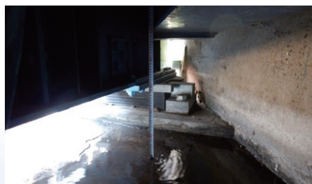
図-7 桁端部滞水状況(A2下り線G1桁)
