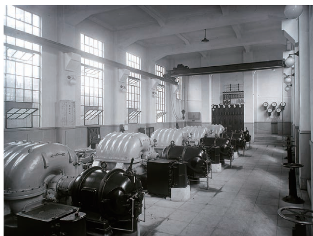
写真7 堀留下水処理場 直結式ブロワ
