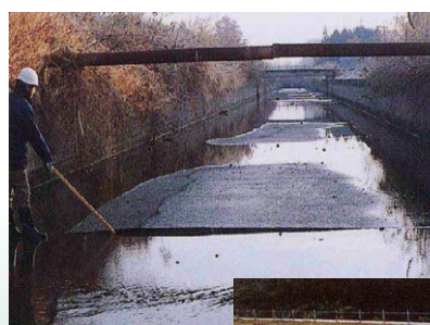
写真8 水路底の浮上、 クラック
