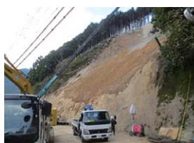
写真-8 崩土除去後の状況 (終点側より撮影)
