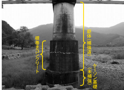
図-2 突出したケーソン基礎
