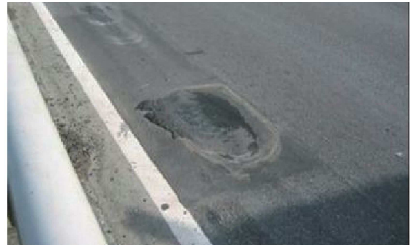
図-5 デッキ貫通型亀裂による路面陥没の事例
