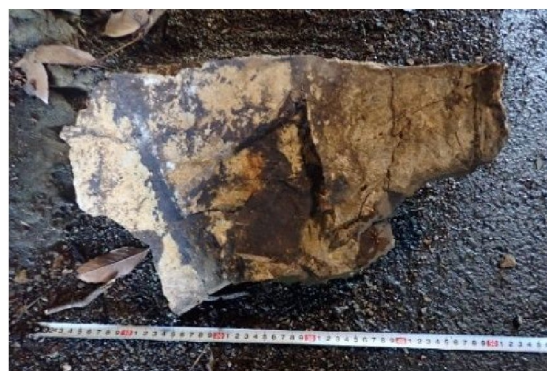
写真-2 令和4年9月に発生した剥離片(50cm角)
