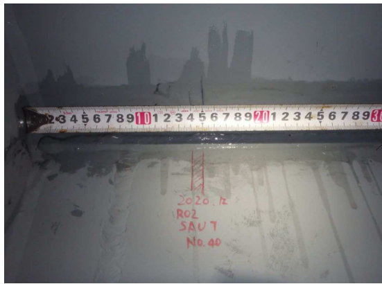
図-10 亀裂内在箇所の写真（亀裂No. 40の場合）
