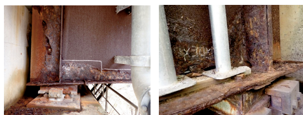
写真-1 桁端部の腐食状況
