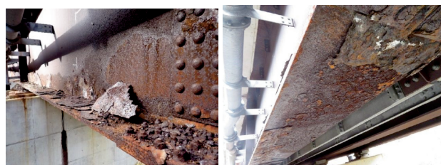
写真-2 開放された面部の腐食状況
