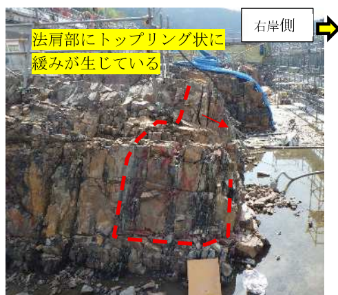
写真-2 法肩部におけるトップリング状の割れ目による緩み
