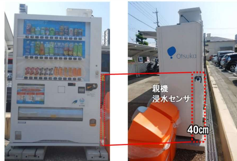
<自動販売機側 浸水センサ 1段>
