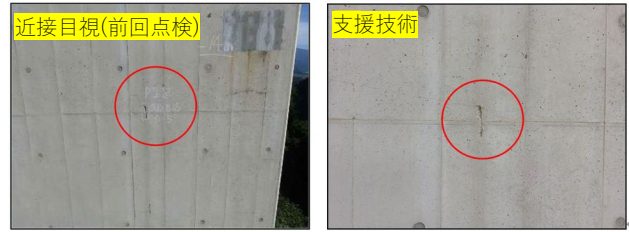
写真-8 はく離・鉄筋露出状況
