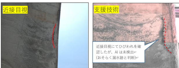
写真-4 ひびわれ未検出箇所
