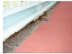
地覆、高欄基部の腐食 (滞水)
