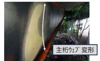
写真-5 主桁変形
