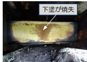
写真-4 横桁下塗り焼失
