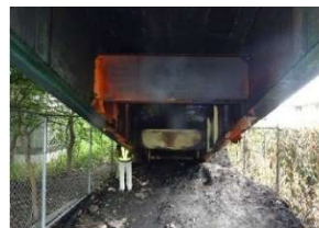
写真-2 被災部全景
