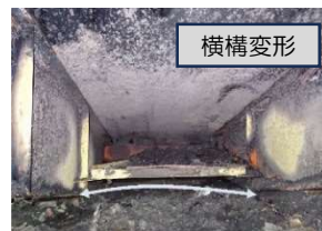
写真-6 横構変形
