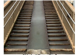
蹴上版の腐食 (滞水)
