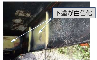
写真-3 主桁下塗り露出
