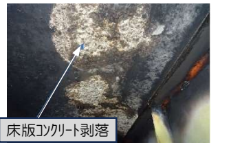
写真-7 床版コンクリート剥落
