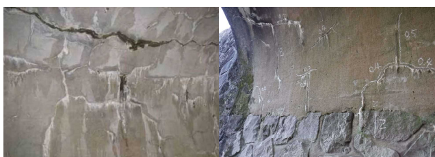
図-3 函体アーチのひび割れ
