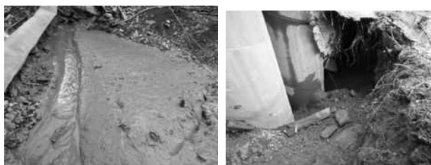
写真-5 削孔水の影響（左：濁水、右：吸出し）
