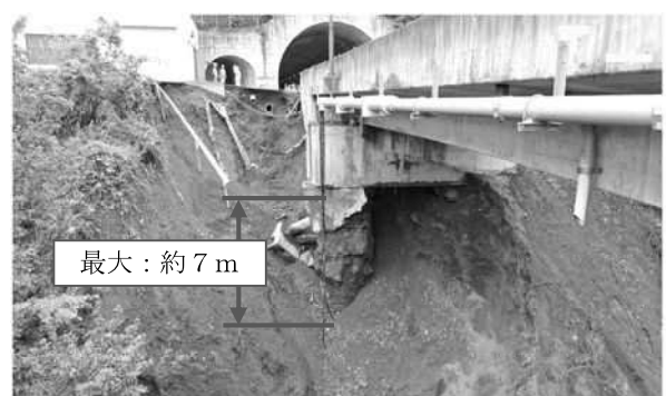
写真-1 災害状況（上：全景 下：崩壊部近景）
