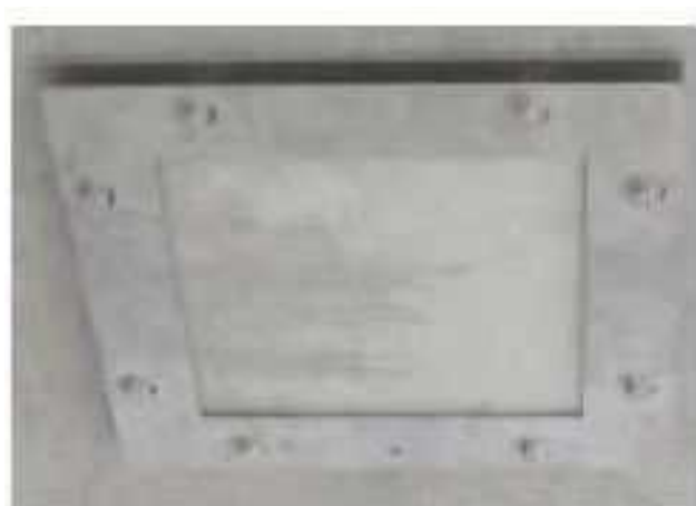
図-3 貼付型熱環境測定装置(EM(S)装置)の設置状況
