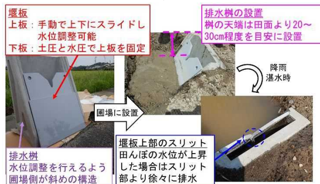
図-10 田んぼ貯留実証実験で使用する排水柵と堰板
