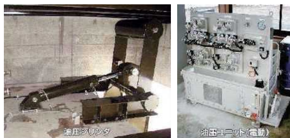
図-8 非常用動力イメージ写真※5
