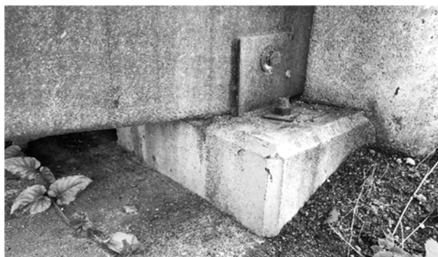
図-5 土砂堆積の様子と台座コンクリートの設置例 (既設木橋例2/愛知県)
