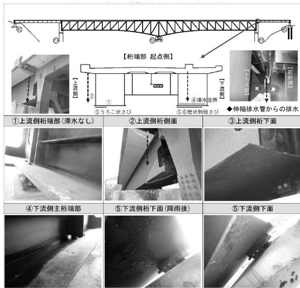
図-10 P3橋脚（箱桁部）における異常さび
