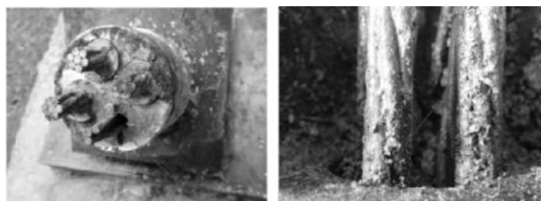
写真-1 テンドンの破断状況
