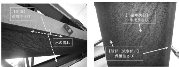
図-7 下弦材下面のさびの状況
